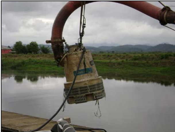
Foto 4 – Detalhe da bomba submersível
